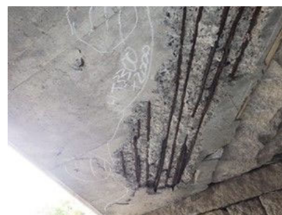
図 1. 4 コンクリート橋の損傷例（判定Ⅲ）
