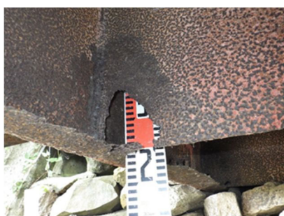
図 1. 3 鋼橋の損傷例（判定Ⅲ）
