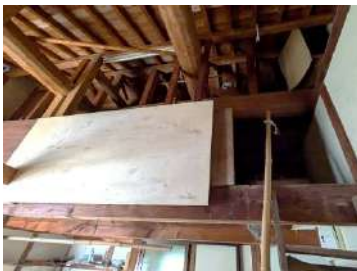
土間2階部分(使用不可)
