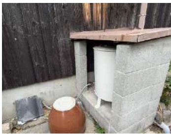
灯油ボイラー
