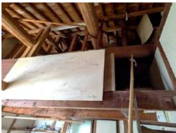
土間2階部分(使用不可)
