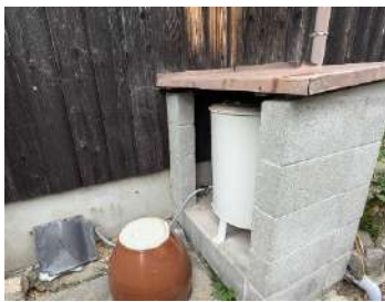
灯油ボイラー
