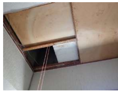
④玄関上 雨漏りの痕
