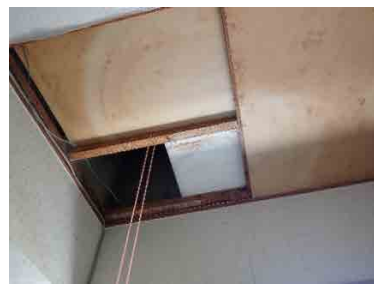
④玄関上 雨漏りの痕
