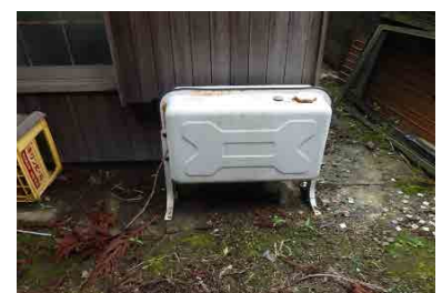
ボイラー設備
