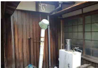
ボイラー設備
