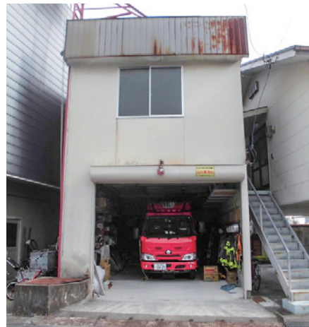
築50年経過している屯所
