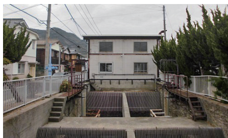
東内浜ポンプ場(昭和60年完成)
