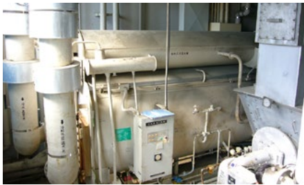
現在の空調設備
